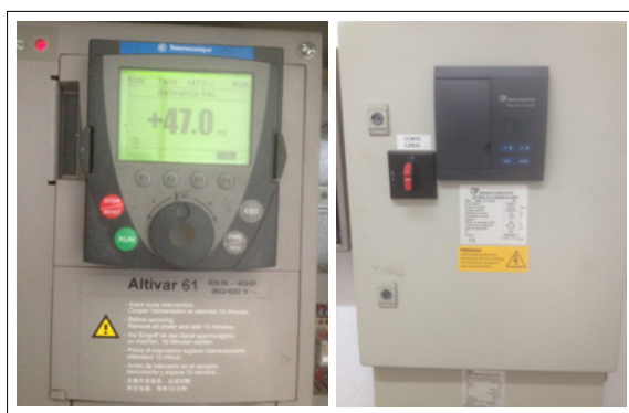
Figura 6. Exemplos de variador de frequência (esquerda) e bateria de condensadores (direita).
