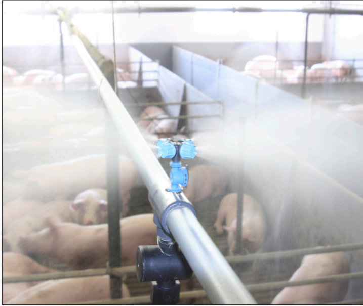
Die Niederdruck-Vernebelungsanlage sorgt für Kühlung im Schweinestall. (Bild: zvg)
