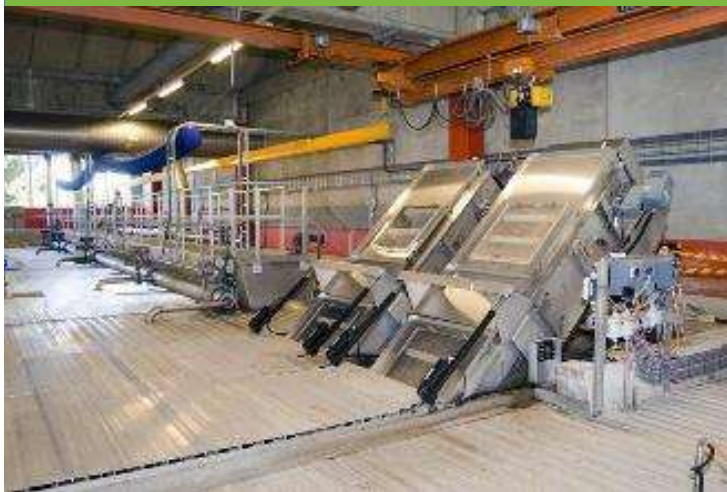
Pilotanlegg for struvittfelling ved Hias, Stange
