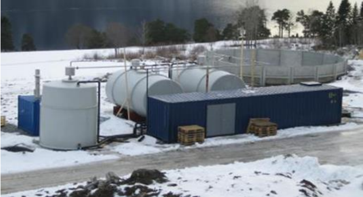
Anaerobic digester in Tingvoll
