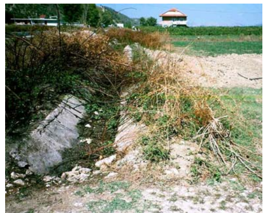
Bild 13: Nicht mehr funktionstüchtiger Bewässerungskanal (Foto: Christian, 2002)
