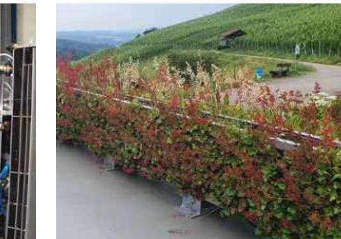
Das Spritzenwaschwasser fliesst über Schläuche zur Pflanzwand.
