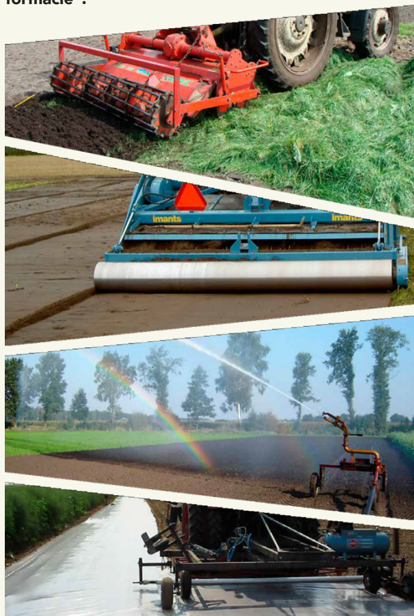
Obr. 1: Anaeróbná dezinfekcia pôdy v krokoch (zhora dole): Zpracovanie čerstvej organickej hmoty Valcovanie povrchu Zvlhčenie pôdy Zakrytie prakticky nepriepustným filmom (PNF)
