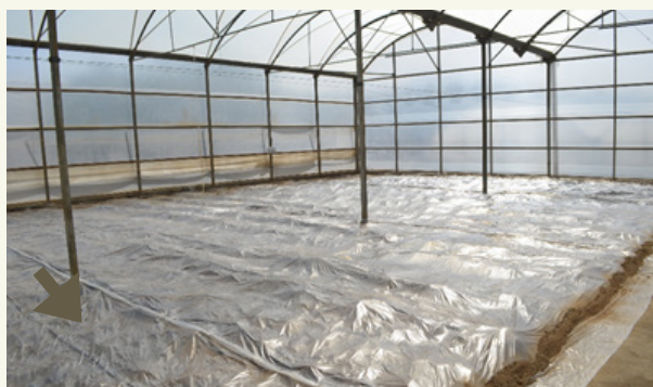
Fig. 3: Após a implantação do filme, as margens são cobertas com solo ou outro material, para evitar perdas de ar aquecido.
