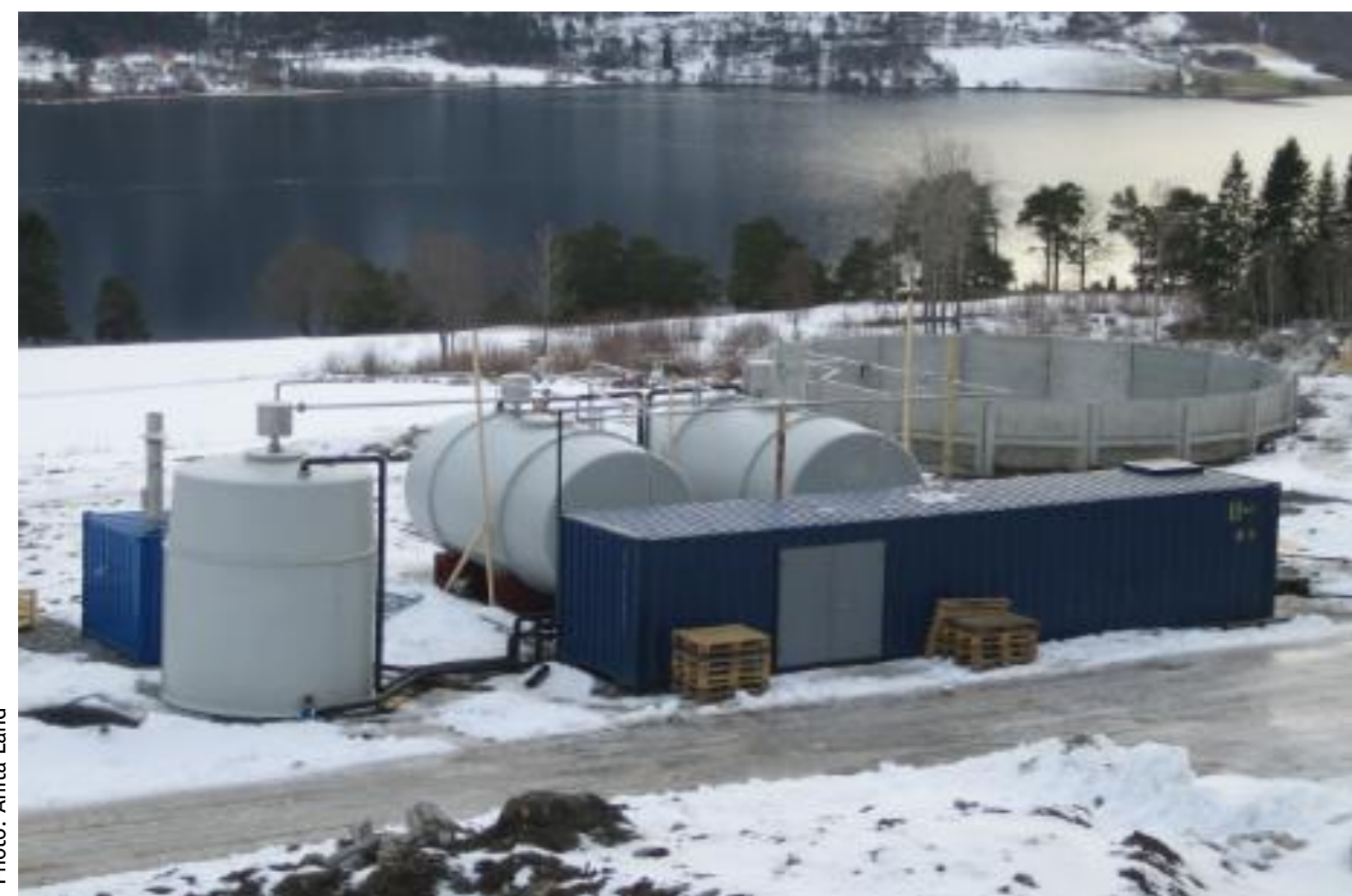
Figur 1. Biogassanlegget på Tingvoll gard. Blå kontainer i forgrunnen inneholder miksetank og pumpestokk. Anlegget har to rånetanker (liggende) og en kjøletank (stående). Anlegget behandler gjødsel fra 25 melkekyr.
