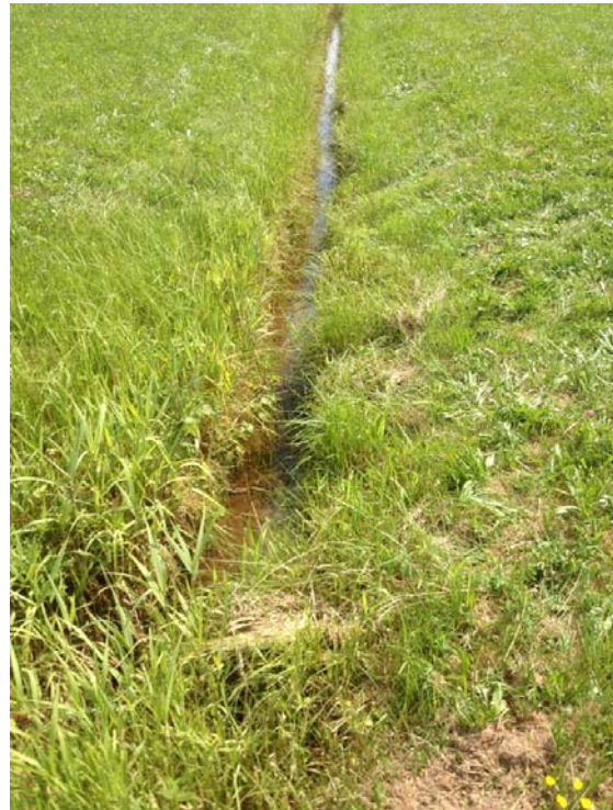
d) Drainagegraben in einer Kuhweide
